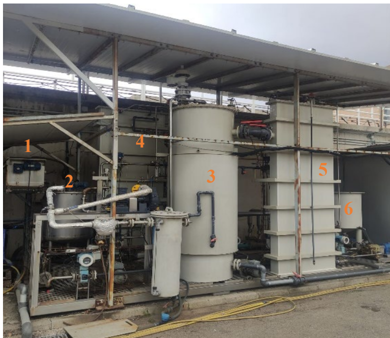
Figura 3.2. Planta piloto AnMBR situada en la EDAR de la Conca del Carraixet.
