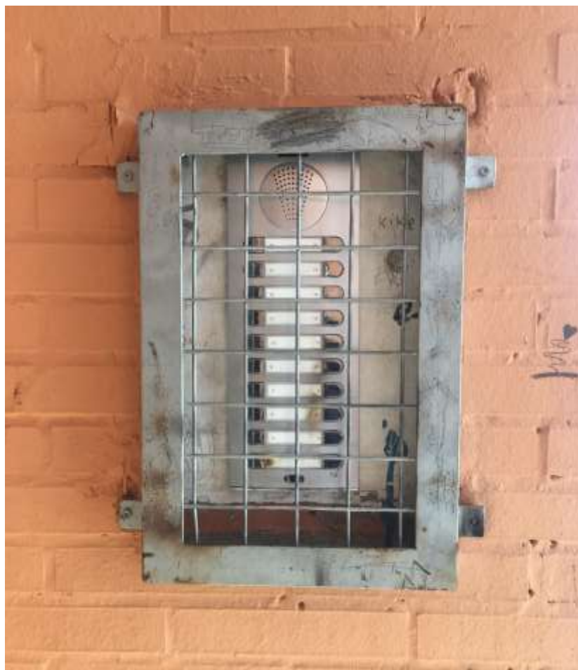
Telefonillo en el Barrio de Bajo Vías (Sagunto).
